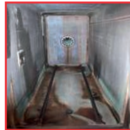
Soporte de filtro izquierdo con corrosión particular Causa: La fuerte oxidación de la cámara de esterilización produce daños por óxido atmosférico/oxidación secundaria
